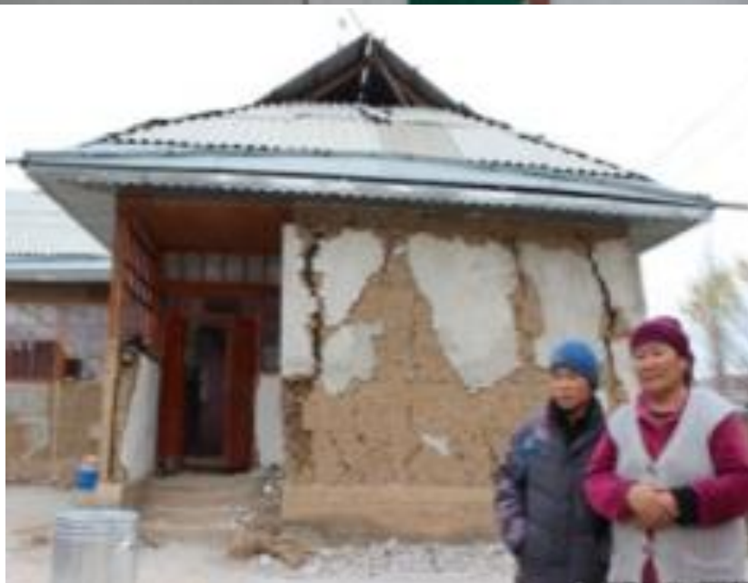
Рис.4. Состояние домов после землетрясения в Карасууйском районе -2015г.
