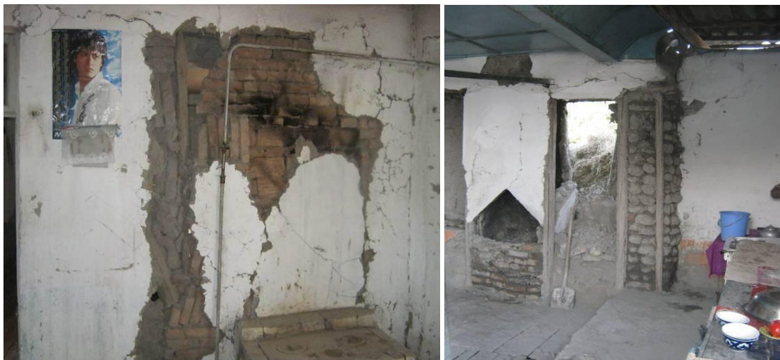
Рис. 3. Повреждения стен сынчевых зданий при землетрясении 20.07.2011 г.
