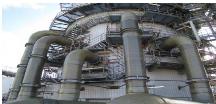
Фигура 10 – Технологические химостойкие трубопроводы
