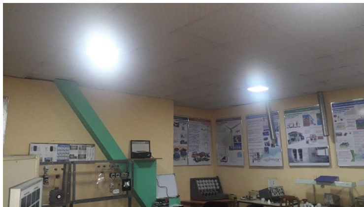
Рис. 2. Система электроосвещения светильниками с диодными источниками света, мощностью 5,5Вт
