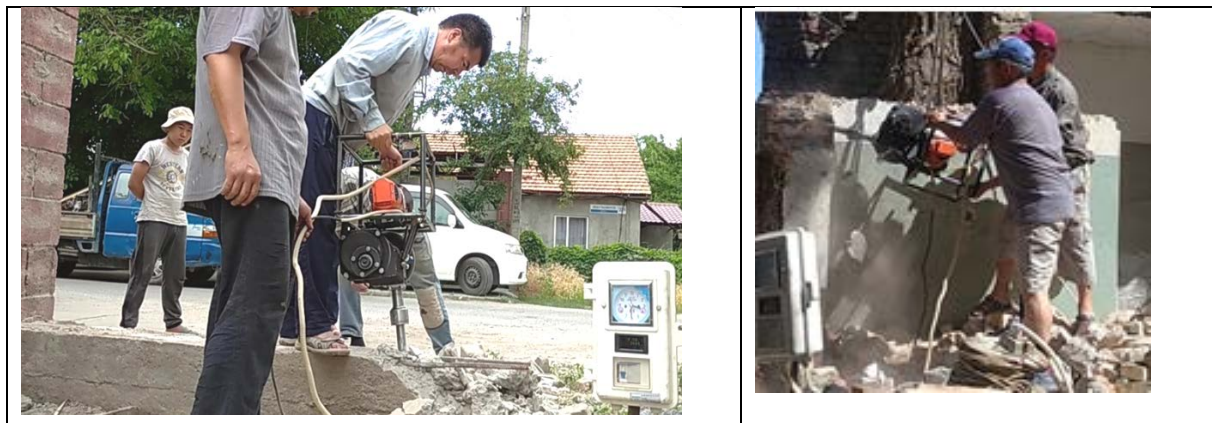
Рисунок 7- Разрушение участка фундамента забора и стены зданий Результаты апробации работы действующего макета пневматического отбойного молотка М15-21
